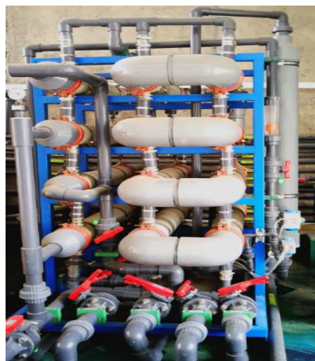
2# VF 管式微濾膜系統
