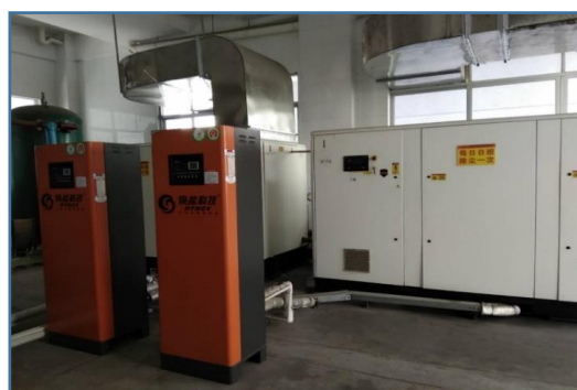
兩台空壓機分別安裝兩台熱交換機
