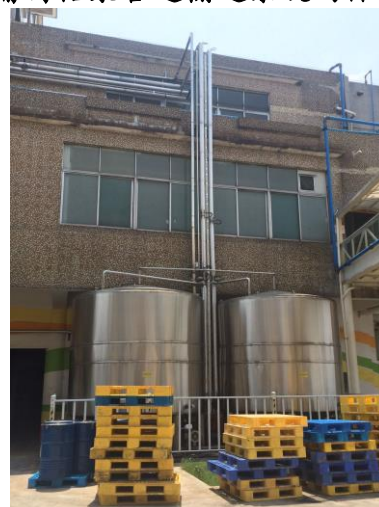
生產車間外的保溫水塔
