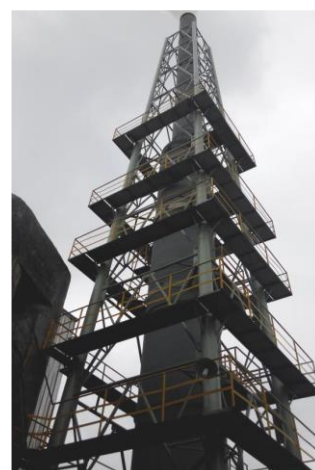
濕式噴淋洗滌塔
