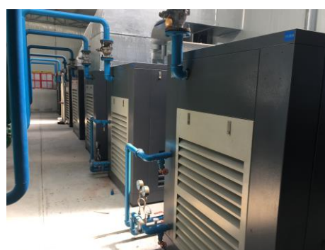
中央控制壓縮空氣的空壓機組
