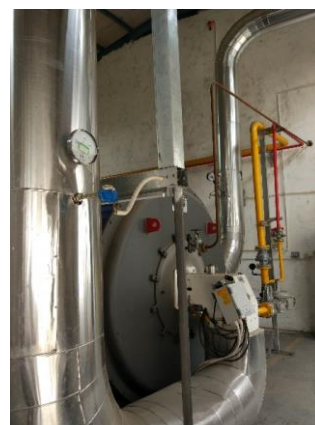
天然氣導熱油爐
