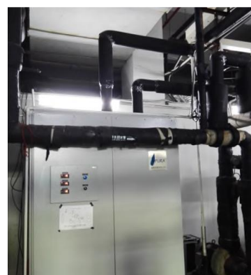
儲冷系統與中央空調系統管路連接
