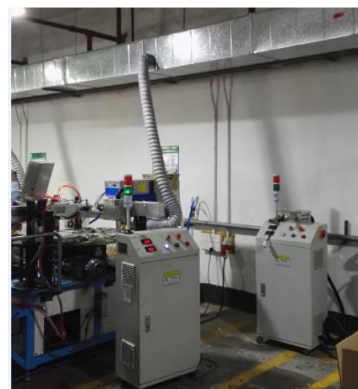
廢氣的收集和排放管道
