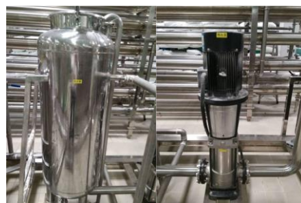
(主體設備) 熱水平衡罐；熱水泵
