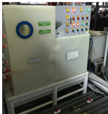
在線除膠渣過濾循環系統外觀
