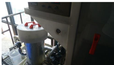
粗化液電解再生與循環過濾綜合系統 過濾單元
