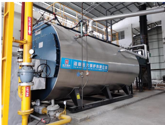
10吨烟气循环燃气锅炉
