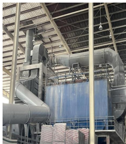
新增余热回收风管
