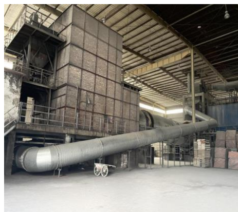
新增余热回收风管
