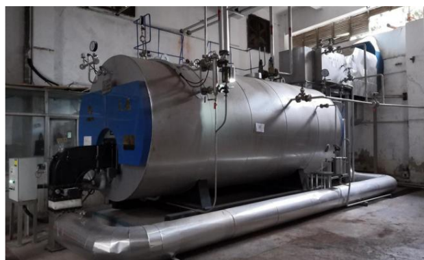
烟气循环燃气蒸汽锅炉
