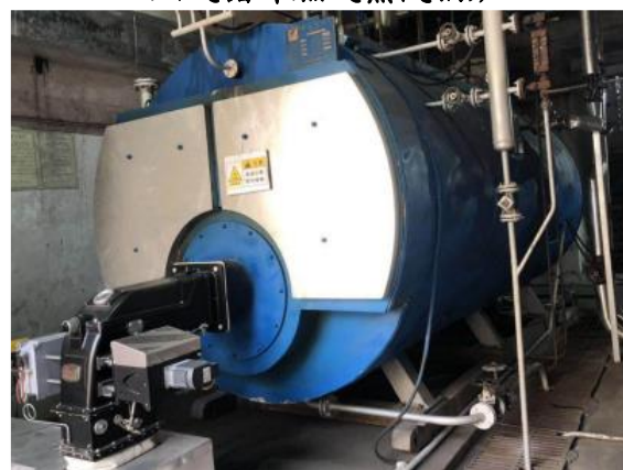
燃气蒸汽锅炉
