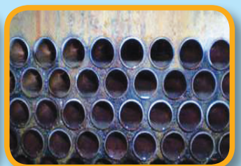
处理后散热器表面产生磁化铁阻止腐蚀产生
