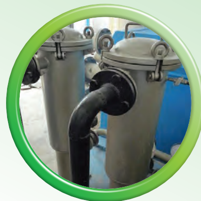
热交换器前的过滤器
