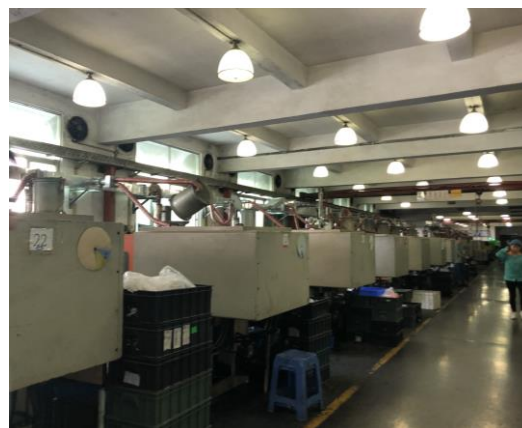
注塑车间废气收集
