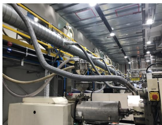
注塑车间有机废气收集
