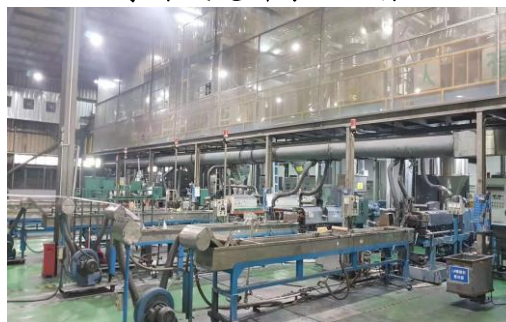
注塑车间废气收集
