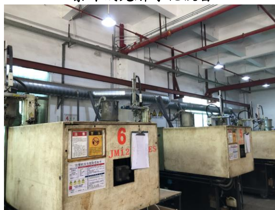
注塑车间废气收集
