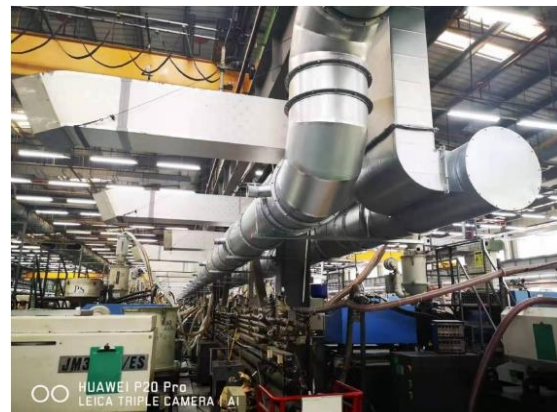
车间收集管道
