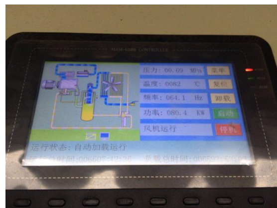
空气压缩机的操作介面
