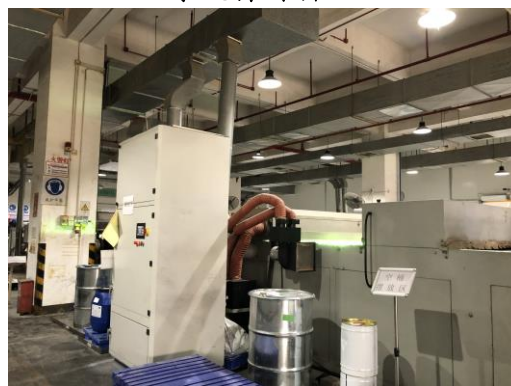
装置位于印刷车间内
