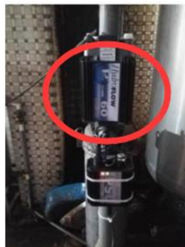
电磁波水垢现场设备安装位置
