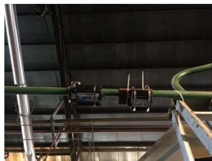
电磁波水垢现场设备安装位置
