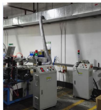
废气的收集和排放管道
