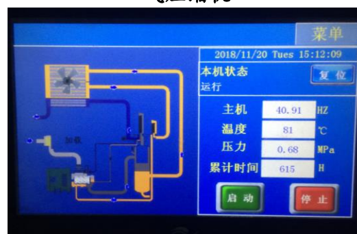
节能螺杆空气压缩机的操作介面
