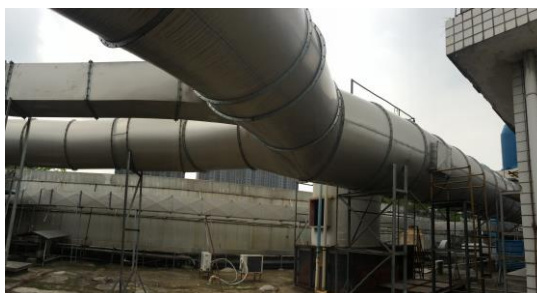
喷涂车间废气收集管道
