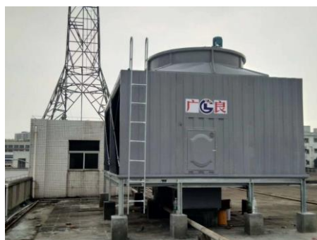
配套冷却水塔
