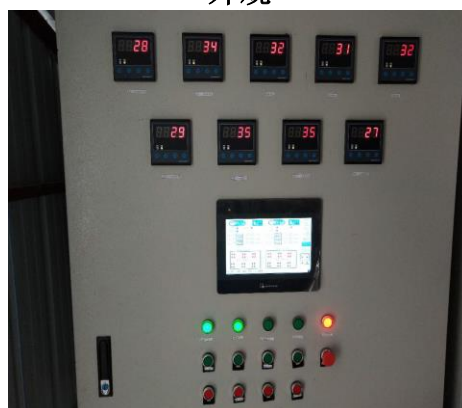
活性炭吸附浓缩及催化燃烧系统操作屏及操作开关
