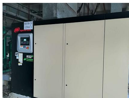
两级压缩螺杆空气压缩机
