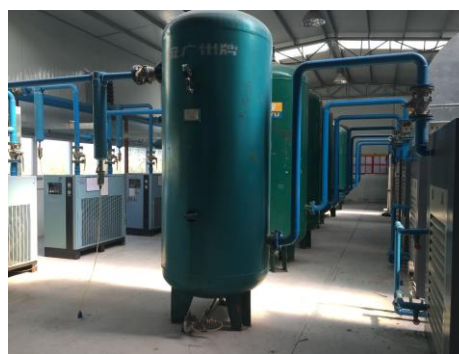
中央控制压缩空气系统
