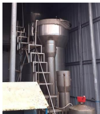
锅炉中央软水器
