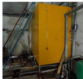
锅炉中央集水缸
