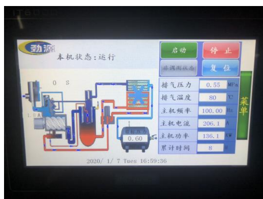
空壓機操作介面
