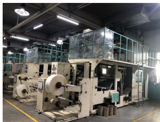
吹膜車間廢氣收集
