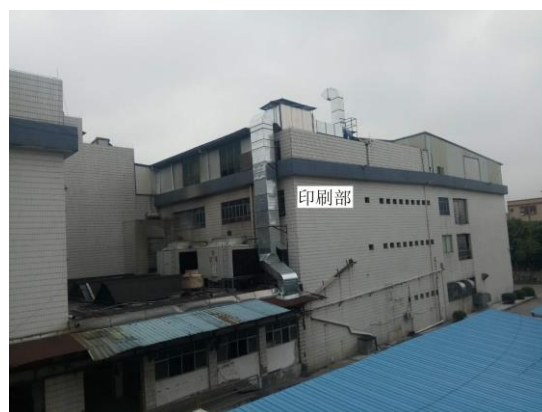
印刷部廢氣處理系統
