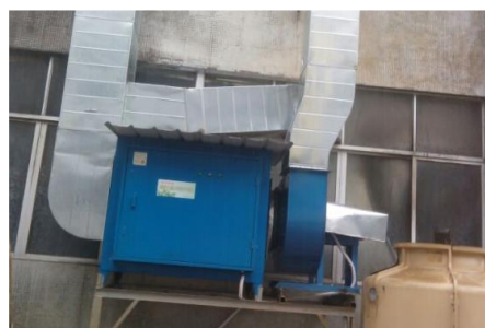
UV 光解處理設備的排氣管道
