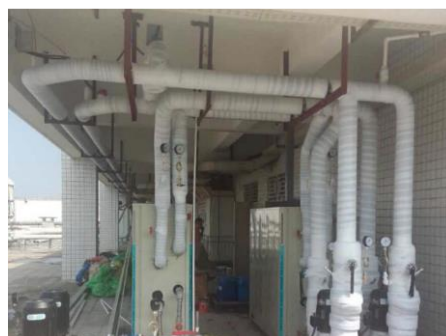
中央冷卻系統的外觀及管道
