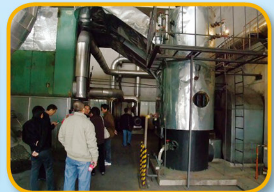
熱管式鍋爐餘熱蒸汽發生器全貌
