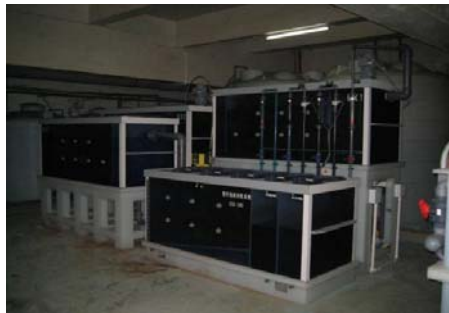
萃取及反萃取設備
