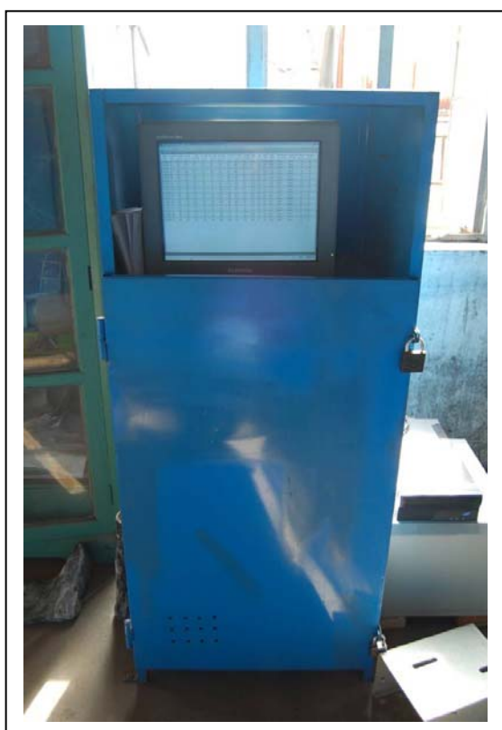
鍋爐煙氣脫硫監控系統
