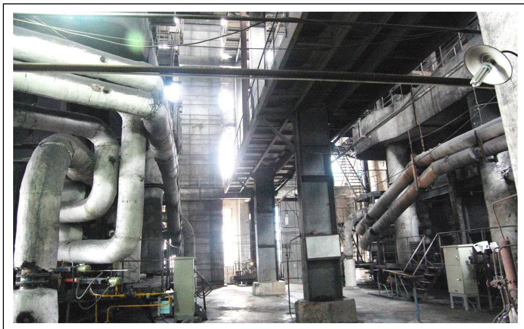
「清潔生產伙伴計劃」示範項目 - 2 台 75t/h「粉煤灰鍋爐」
