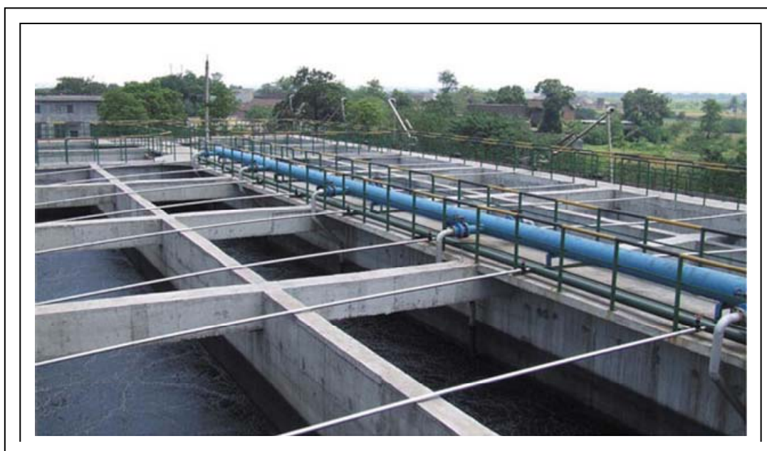
廢水處理設施
