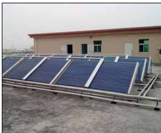
太陽能供電系統
