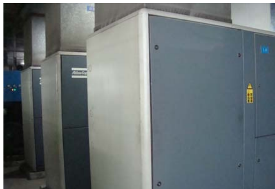
3 台 75kW 的 GA75 型螺桿空壓機
